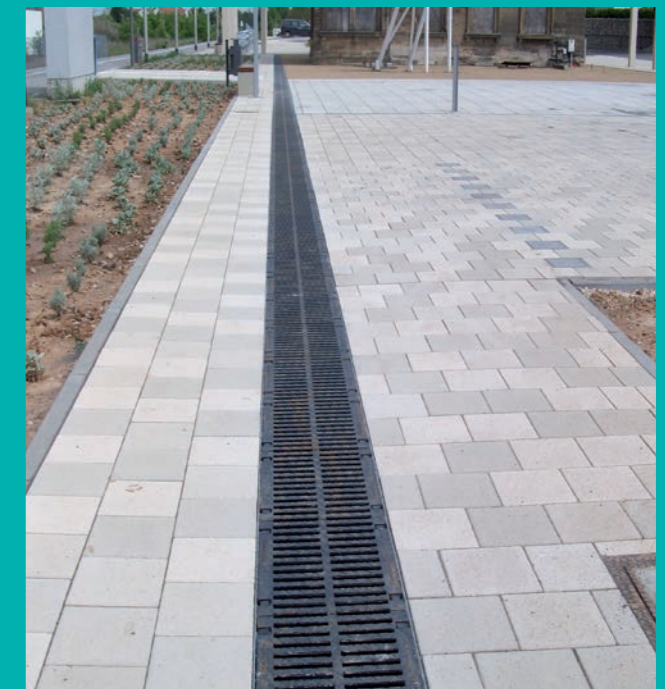
System DRAINFIX®CLEAN po ukończonej instalacji.
